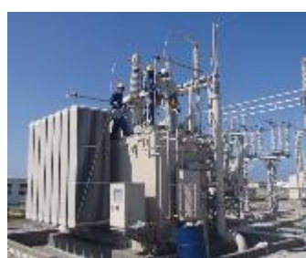
例) 変圧器点検
