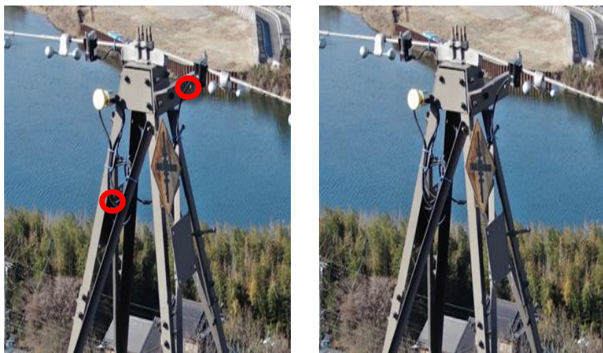
●鉄塔のボルト脱落検出例（左：検出後（赤丸部） 右：検出前）
