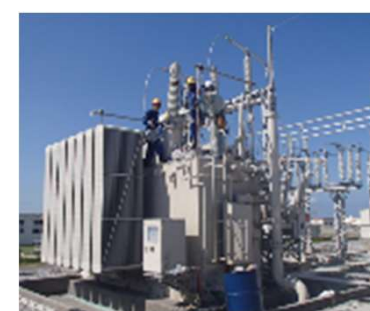
例) 変圧器点検
