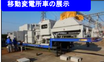
移動変電所車の展示
