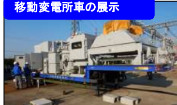
移動変電所車の展示
