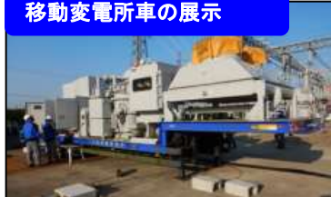
移動変電所車の展示
